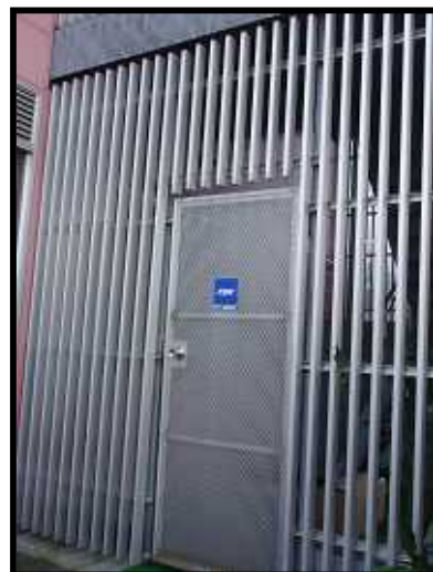
写真 3－28 三明電子産業(株)の裏の外階段
