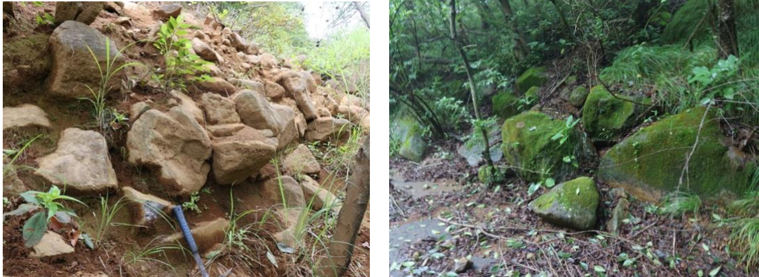
図6（左）崩壊地近くの地山の溶岩露頭。褐色粘土化した層の中に風化に耐えた溶岩塊が含まれる。 （右）崩壊地近くの地山とみられる場所の地表。風化産物とみられる溶岩塊の転石が散乱している。
