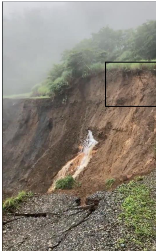
図3 近隣住民が7月3日に撮影したネット上の動画（ https://twitter.com/keikootara/status/1411203575267532802 ）より。褐色部（四角枠は図2Dの撮影部分）から水が吹き出している。
